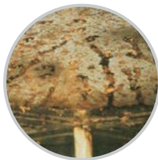
▲ 용접식 STS Tank 기상부 : 염소 Gas에 의해 부식발생
