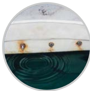
▲ 기상부 일반 STS Bolt 적용시 : 염소 Gas에 의해 부식발생
